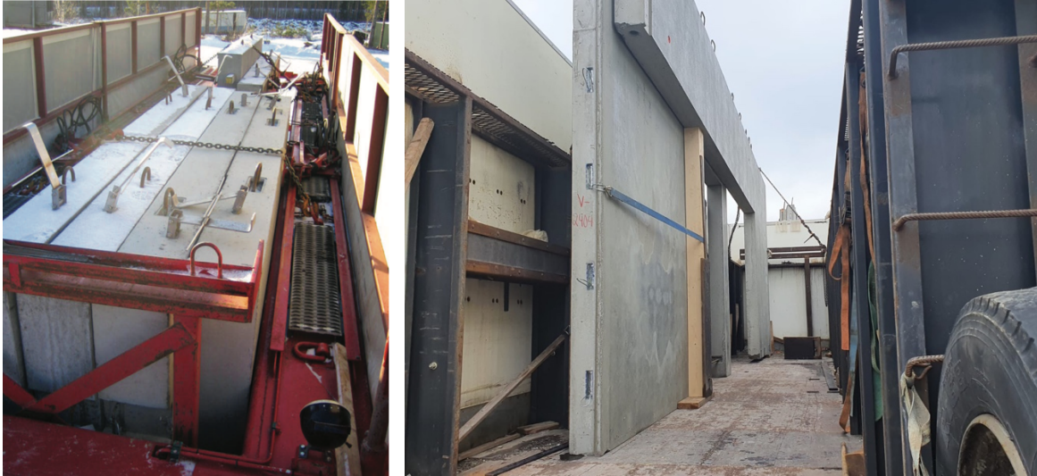
Vasemmassa kuvassa elementit varmistettu kampaan tukemalla ja sitomalla ketjuilla. Oikealla olevassa kuvassa esimerkki suunnittelijan määrittämästä kirveskiven kuljetustuesta.
